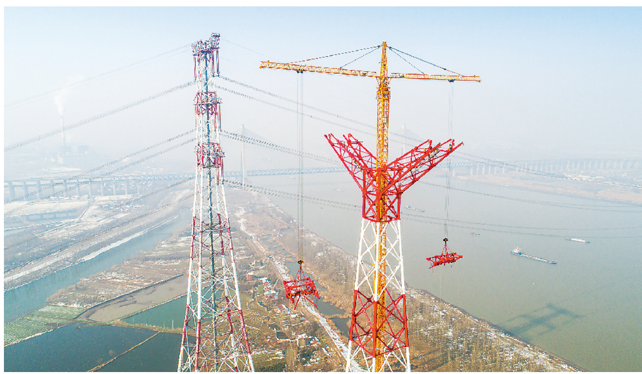
世界最长最高电压等级输电工程长江大跨越杆塔封顶 2 月 6 日,世界上输电距离最长、输电量最大、电压等级最高的输电工程——昌吉—古泉±1100 千伏特高压直流输电工程长江大跨越工程南岸跨越塔成功封顶。图为在安徽省繁昌县荻港镇,跨越塔在进行横担吊装施工。新华社发
